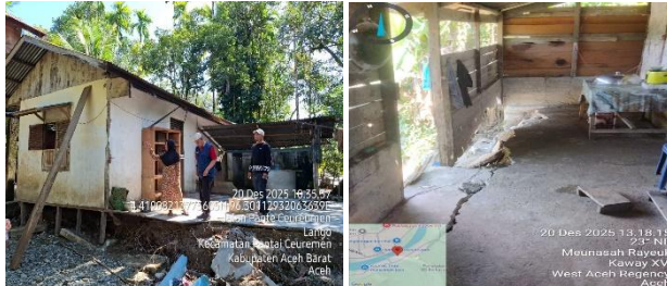
Gambar 6. Kondisi Struktur Lantai
