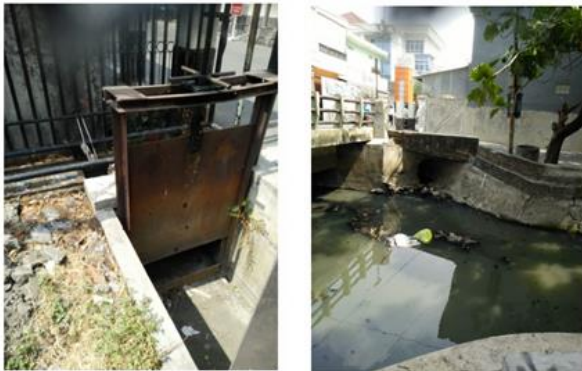
Gambar 4. Pintu air pengatur dan intake bila air penuh terjadi alir balik
