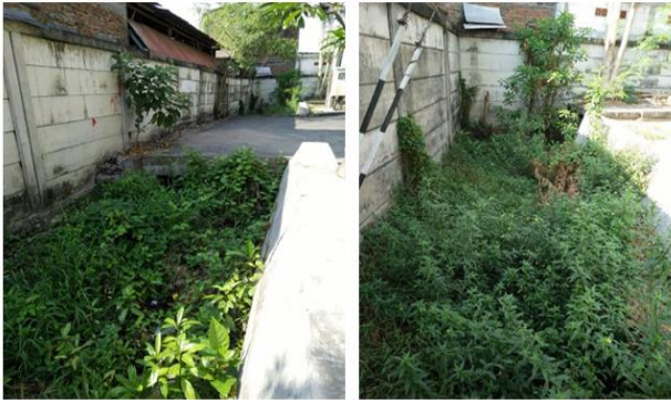
Gambar 1. Kondisi saluran tersier sekeliling kampus tertutup tumbuhan. (lokasi saluran utara gedung A8)
