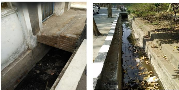
Gambar 2. Kondisi saluran tersier kanan kiri sisi kampus ketintang terdapat sedimentasi lokasi saluran sebelah barat gedung mipa dan parkir fakultas teknik
