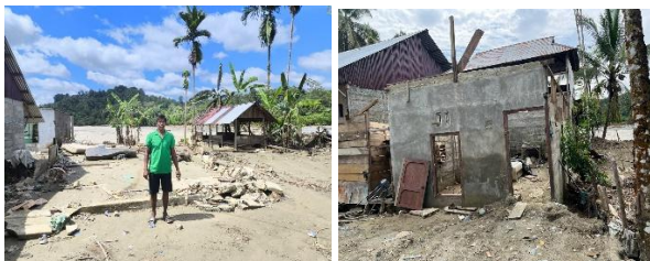
Gambar 2. Kondisi Rumah Warga
