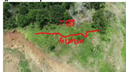
Gambar 12. Area patahan Sumber : PT. PLN
