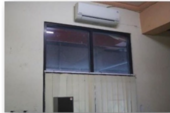
Gambar 4. Indoor Unit Sistem Spill Pada Ruangan Gedung F
