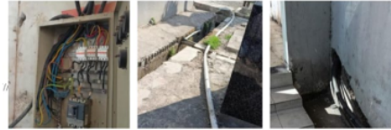
Gambar 25. Kondisi Panel dan Kabel Gedung F
