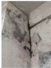
Gambar 14. Kondisi Pelat lantai 4
