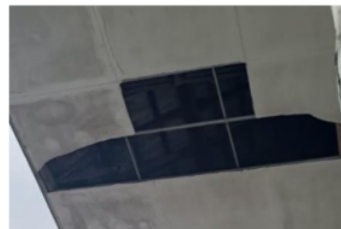
Gambar 17. Kondisi Rangka Atap
