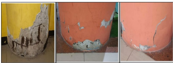
Gambar 9. Kondisi Kolom Bangunan Lantai 1
