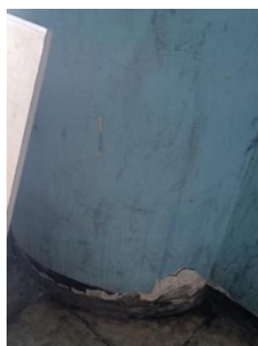
Gambar 10. Kondisi Kolom Bangunan Lantai 2
