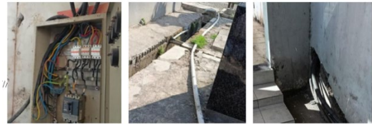
Gambar 25. Kondisi Panel dan Kabel Gedung F
