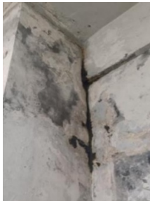
Gambar 14. Kondisi Pelat lantai 4
