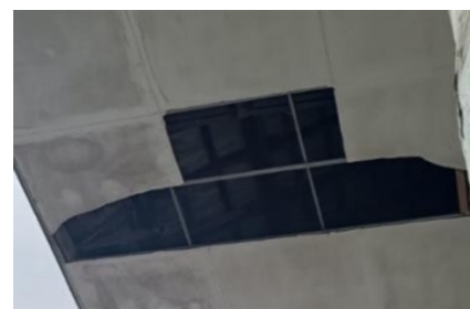
Gambar 17. Kondisi Rangka Atap
