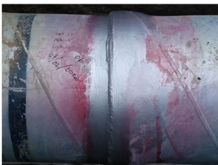
Gambar 2. Hasil pengelasan socket welded yang sudah di penetrant (sumber data internal OP BBWS Brantas)
