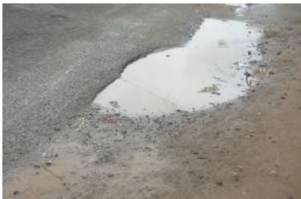
Gambar 2. Jalan Berlubang dan Tergenang Air. Sumber: Hasil Survei 2016
