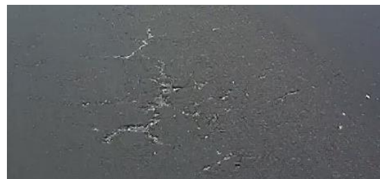
Gambar 4 Kerusakan pada STA 2+100 – 2+200 (Sumber: BlackVue, diakses bulan Maret 2024)
