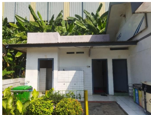
Gambar 5 Kondisi Eksisting Toilet Stasiun Indro Sumber : Penulis, 2024
