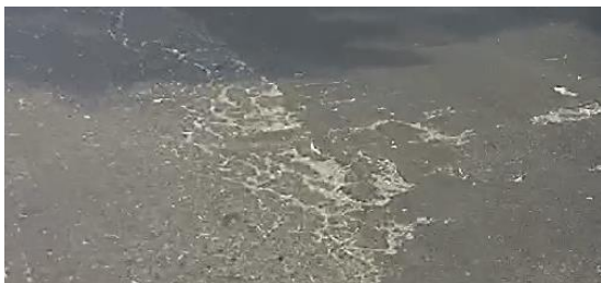
Gambar 3 Kerusakan pada STA 0+000 – 0+100 (Sumber: BlackVue, diakses bulan Maret 2024)
