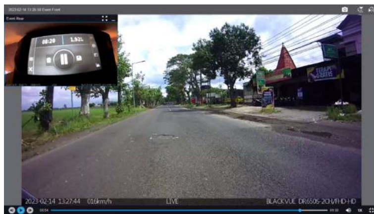
Gambar 4. Lubang Pada Ruas Kiri
