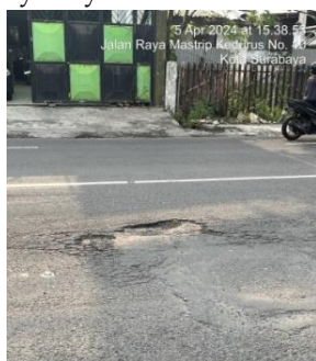
Gambar 1. Kerusakan Lubang Di Jalan Mastrip (Dokumentasi Pribadi, 2024)
