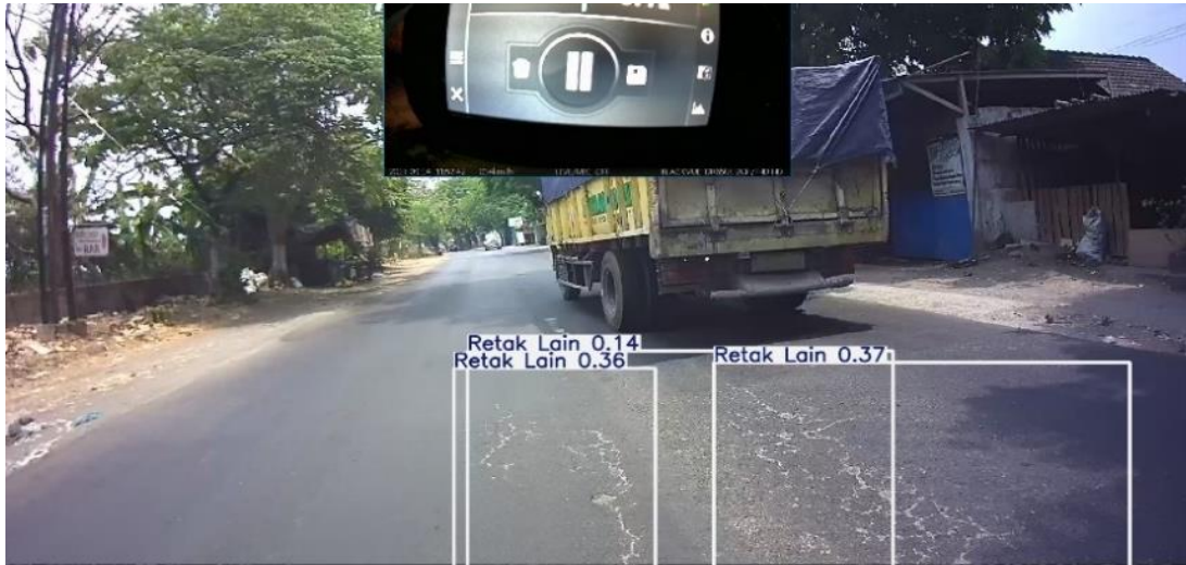
Gambar 6 Kerusakan pada STA 2+600 – 2+700 (Sumber: BlackVue dan Prototype Penulis, diakses bulan Maret 2024)
