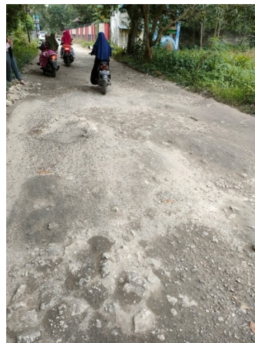
Gambar 2 Kerusakan Jalan di Jl. Raya Jaddih
