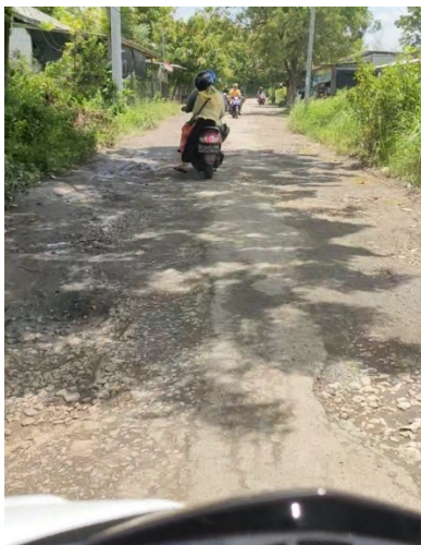
Gambar 1 Kerusakan Jalan di Jl. Raya Labang
