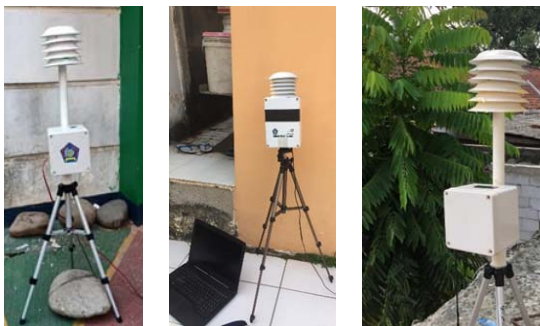
Gbr. 11 Contoh instalasi sensor node .
