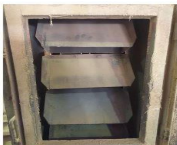
Gambar 10. Posisi Bucket di dalam casing Bucket Elevator M2202
