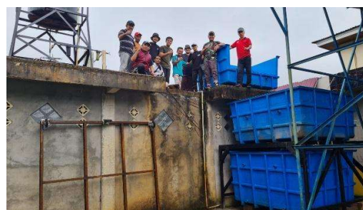
Gambar 3. Teknologi pengolahan air yang telah terpasang pada sumber air
