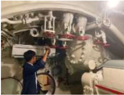
Gambar 5 Ruang Kendali Katup Monumen Kapal Selam Surabaya (Sumber: data primer diolah, 2024)
