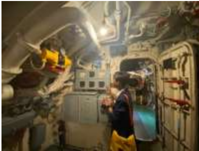
Gambar 11 Ruang Listrik Monumen Kapal Selam Surabaya (Sumber: data primer diolah, 2024)
