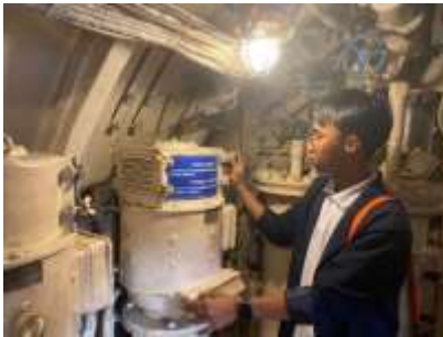
Gambar 6 Alat Pompa Hidrolik Monumen Kapal Selam Surabaya (Sumber: data primer diolah, 2024)
